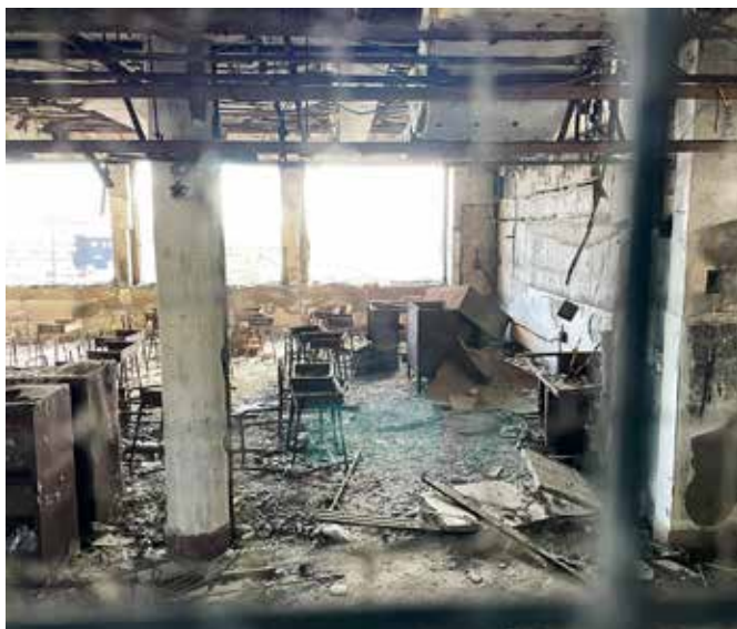
▲津波被害と火災被害後の門脇小学校内部
