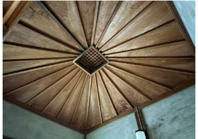
▲浴室の天井 中央に換気口がある
