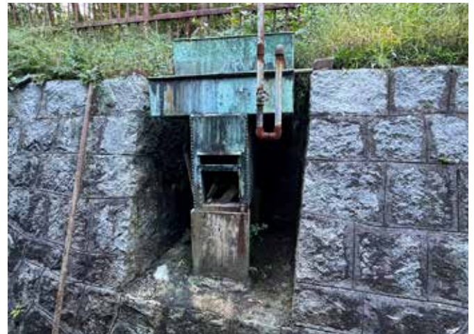
▲外部にある銅製(?)のボイラー。当初のもの
