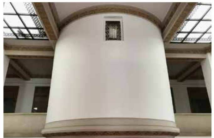
▲螺旋階段の外部。とても美しく、時間を忘れ入ってしまう空間
