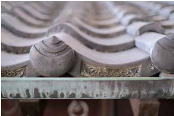
▲修理前の瓦（神の湯本館）
