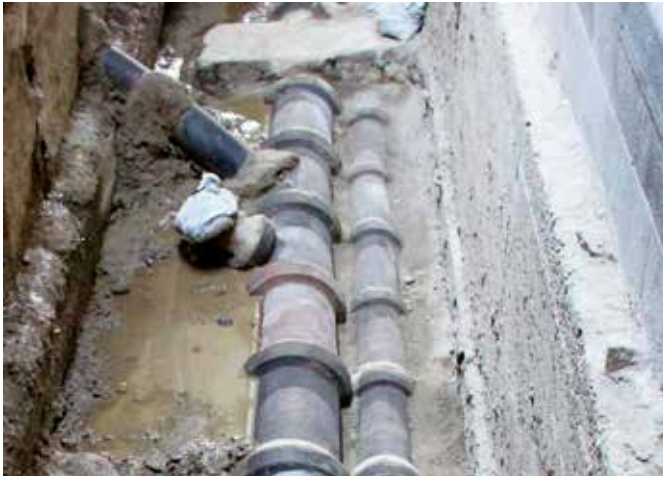
▲ 陶管と浴室の接続部
