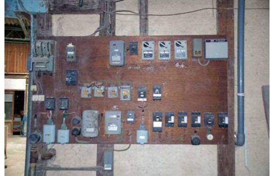
次々と増設されたとみられるブレーカーを打ち付けた板
