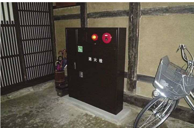
土間に設置された易操作性消火栓
